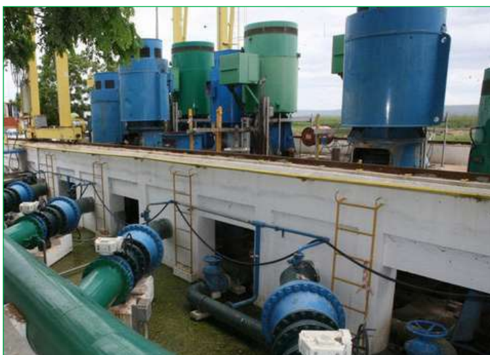
Fig. 43. Estação de Tratamento de Águas Residuais - ETAR.
