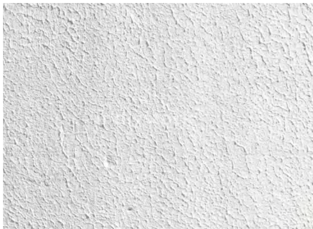
Figura 19 Superfície de uma parede: textura fabricada.
