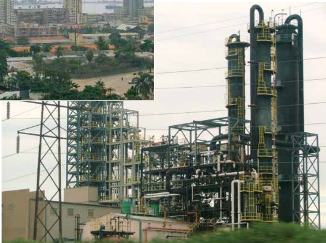
Fig. 25 - Central de produção e distribuição de energia eléctrica.
