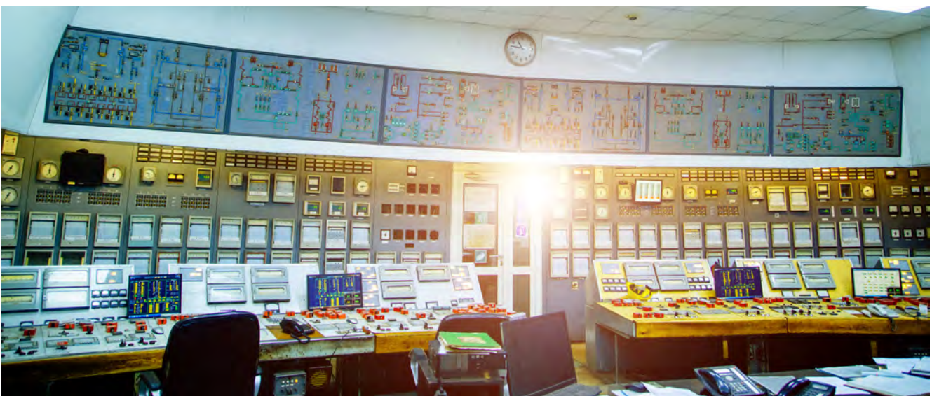
Fig. 95 - Sala de controlo de transportes.
