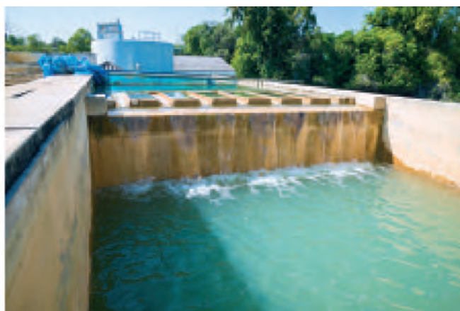
Fig. 79 - Tratamento da água.
