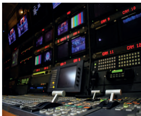
Fig. 73 - Centro de controlo televisivo.
